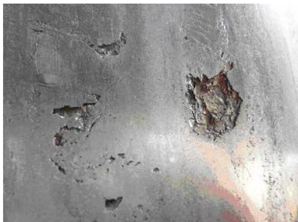
Obr. 3-12 Oblast trhlin na jízdní ploše doprovázena vylupováním [11]
